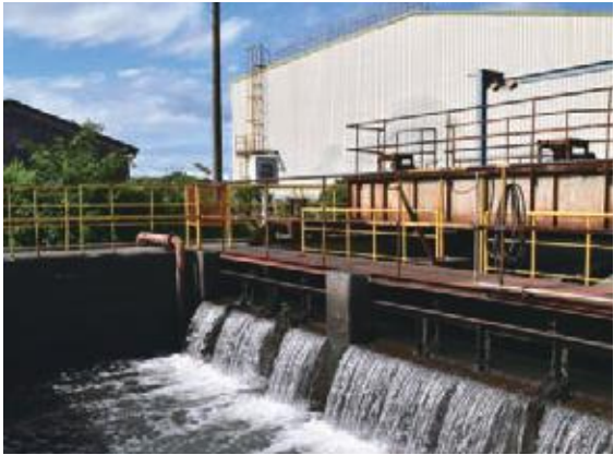
排水処理施設
