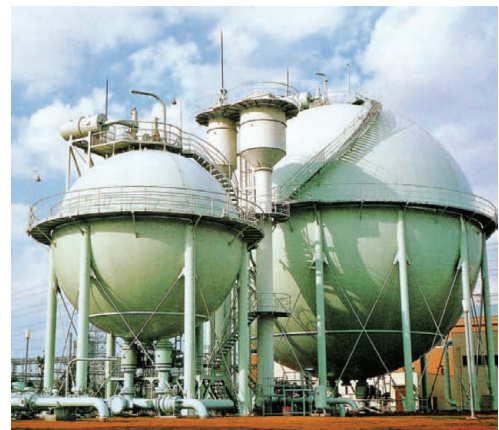
液化天然ガス貯蔵タンク *4-3)
