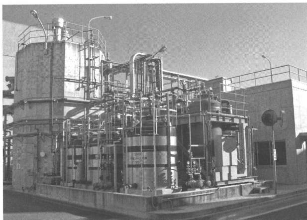
写真1 排水処理設備外観写真
