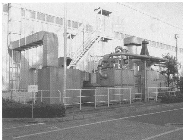
写真2 輪軸塗装ラインVOC処理装置 (交通産機品カンパニー) 設置対象 : 輪軸塗装ライン 排風量 : 290Nm 3 /min VOC濃度 : 最大濃度 560ppm : 平均濃度 150ppm : 処理後濃度 22ppm VOC除去率 : 85%以上
