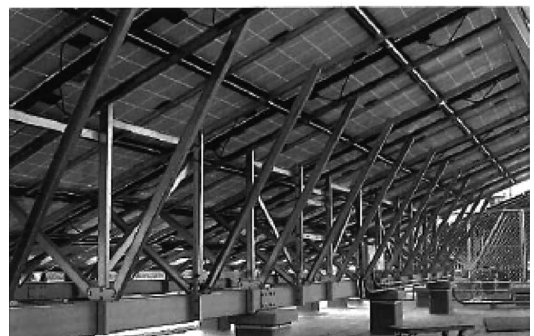
図 4 ソーラーパネル架台の写真
